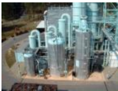
Thermische Vernichtungsanlage mit Abgasreinigung
