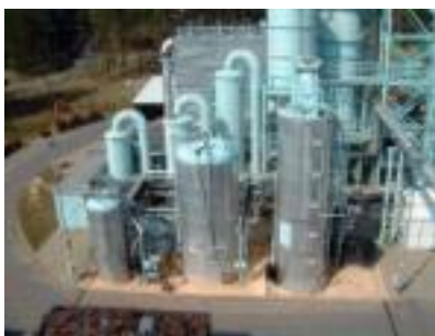
Thermische Vernichtungsanlage mit Abgasreinigung
